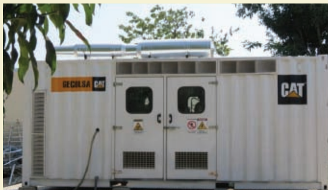
Generador de energía eléctrica a partir de gas natural, instalado en la sede principal de Surtigas
